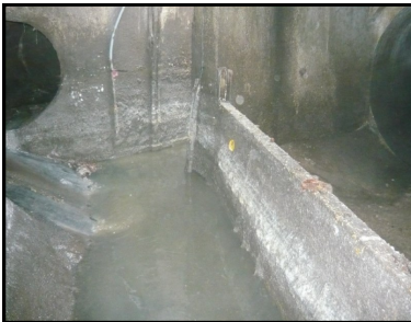
Déversoir d'orages sur réseau
