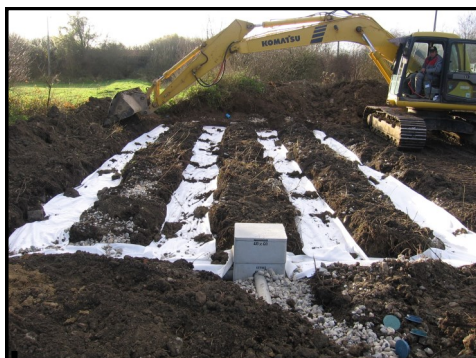
Ouvrage d'assainissement non collectif
