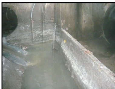
Déversoir d'orages sur réseau
