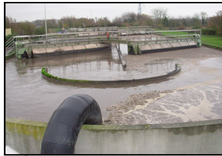
Usine d'épuration de Sin-le-Noble
