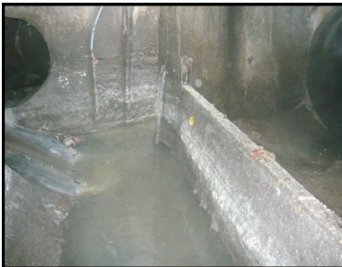
Déversoir d'orages sur réseau
