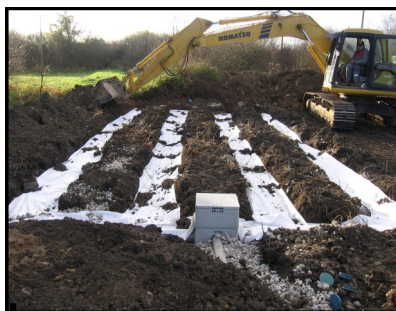
Ouvrage d'assainissement non collectif
