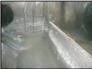
Déversoir d'orages sur réseau
