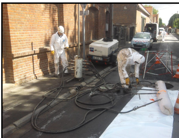
Réhabilitation des collecteurs - étanchéité des canalisation par gainage / rue Marcel Leroy à Esquerchin
